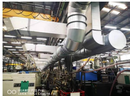
車間收集管道
